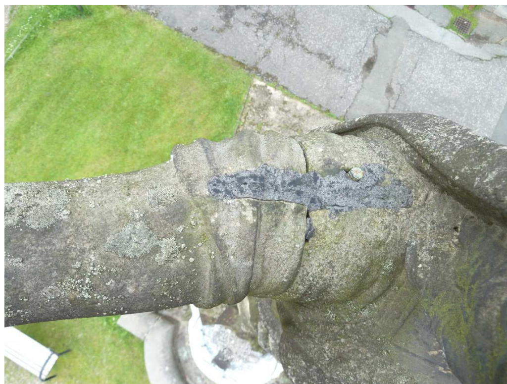
Socha Spravedlnosti. Kovová kotva pod vrstvou cementového tmelu v pravém rameni sochy.
