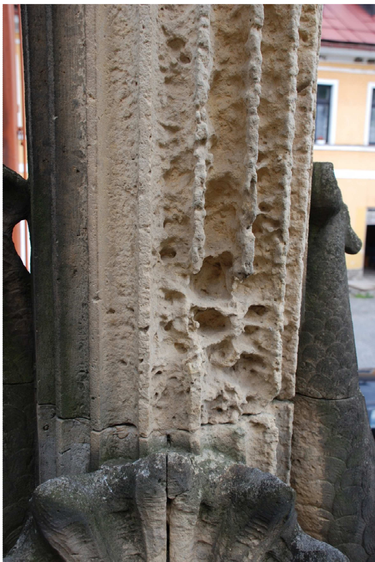
Sloup. Narušená statika vlivem hloubkové koroze kamene ve spodní části sloupu.
