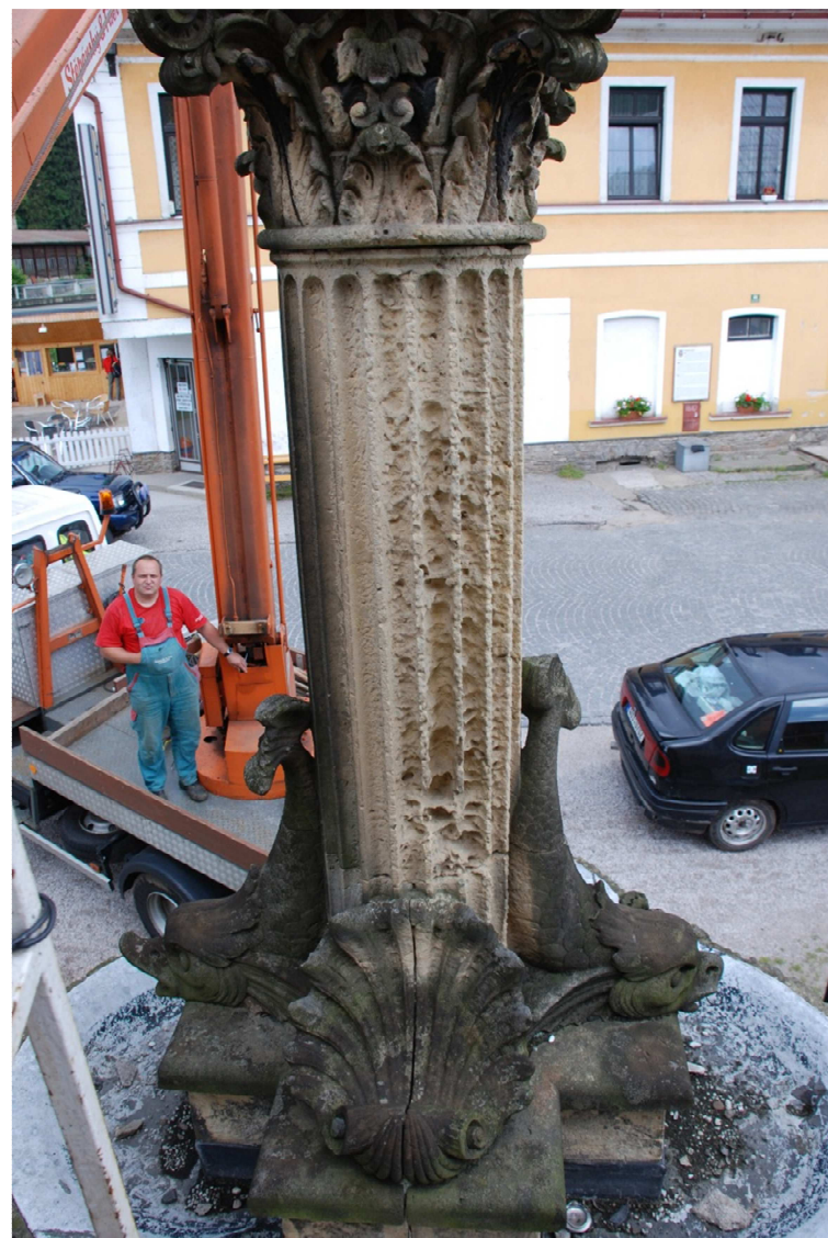
Sloup. Hloubková koroze sloupu – celkový pohled. Absence maltové výplně ve spárách.
