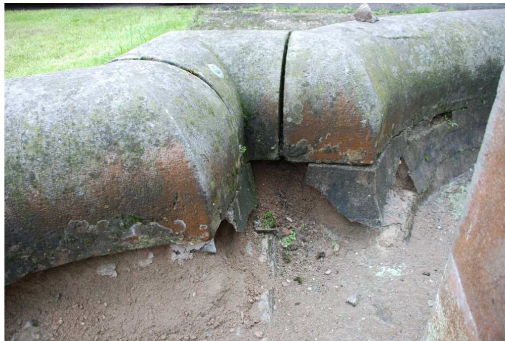
Spodní nádrž. Poškozený základ kamenné obruby způsobuje rozvolnění jednotlivých kamenných bloků.
