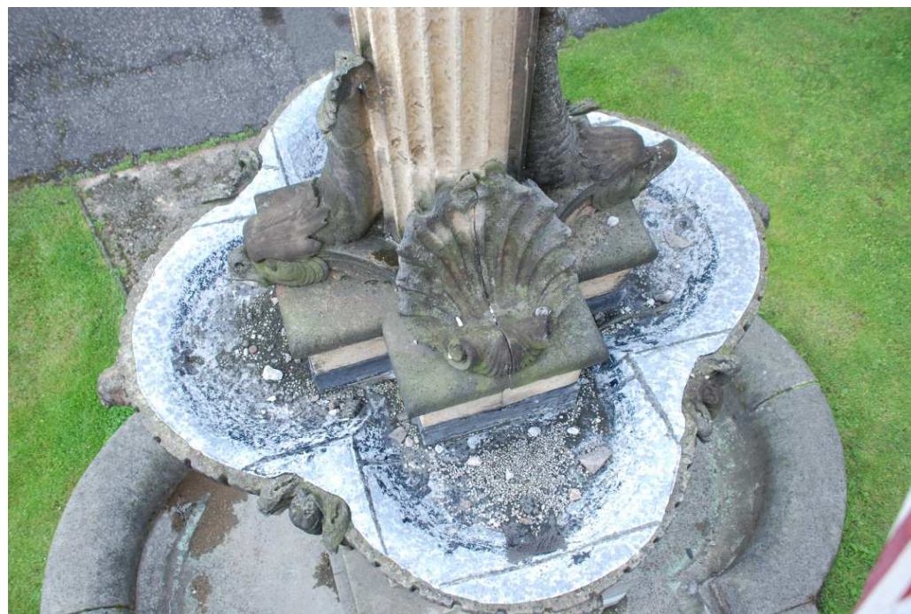
Horní mísa s chrličí. Nefunkční poškozená hydroizolační vrstva olověného plechu na vnitřní stěně mísy.
